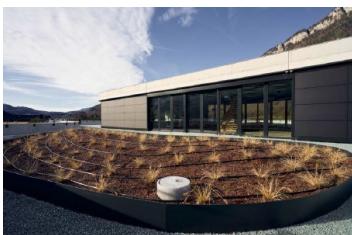
Numerosi collegamenti, come ad esempio in corrispondenza delle fioriere, hanno richiesto un lavoro accurato da parte dell'impresa di copertura.
